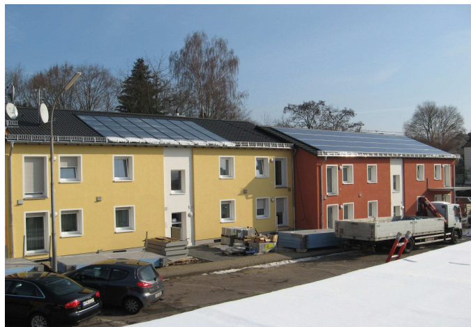
Kombination PV-Solarthermie, Schubertstraße, Neuwied
